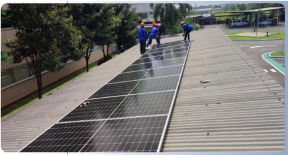
Instalasi Solar Panel sebagai inisiasi mengubah penggunaan listrik yang ramah lingkungan.
